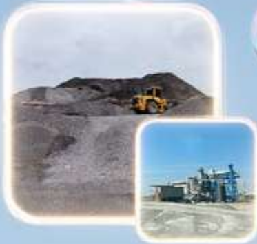
ฐานผลิตคอนกรีตมาตรฐาน
